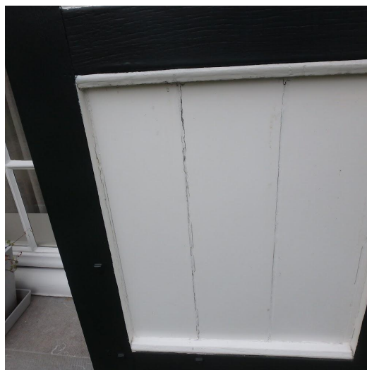
de naden van de invulpanelen scheuren in
