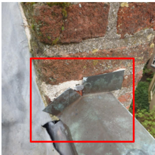
vleugel [1]-zuid: de buitenopstand van de koperen goot is niet waterdicht aangewerkt, de aangebrachte loodslab is ontoereikend
