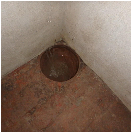
er staat water in de pompelomp
