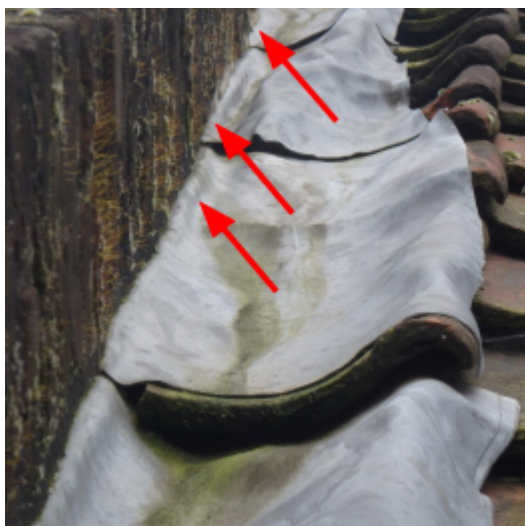
er is geen of onvoldoende hoge opstand aangebracht
