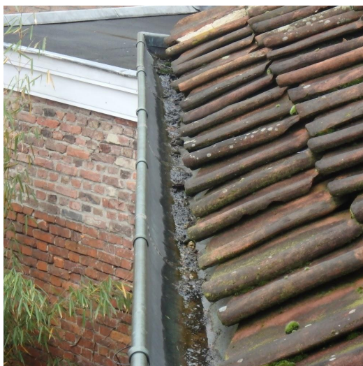
licht vervuilde goot
