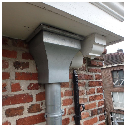
vleugel [1]-zuid: afvoer en vergaarbak zijn in zink uitgevoerd, de vergaarbak zit te hoog
