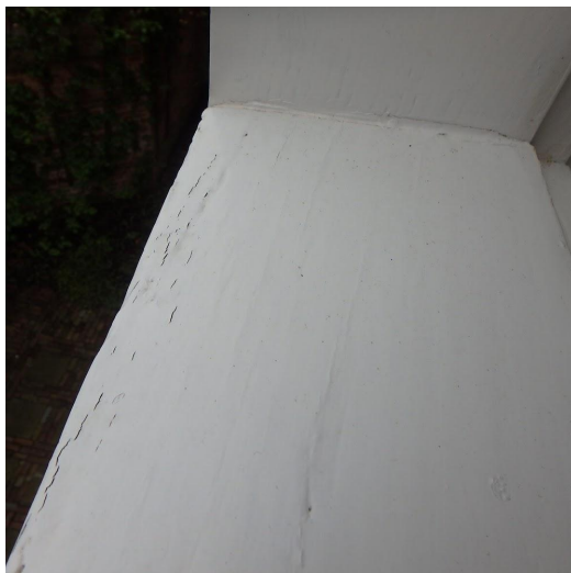
het schilderwerk begint te craqueleren
