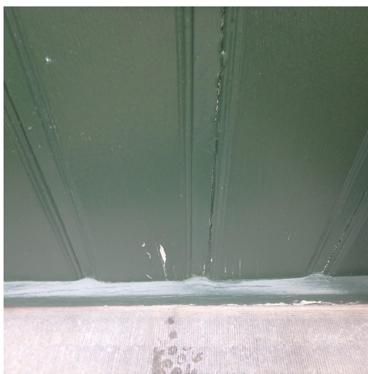
het schilderwerk begint te craqueleren
