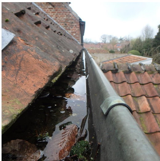
sterk vervuilde goot
