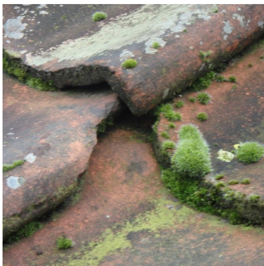
dak [2]: stukje afgebroken pan
