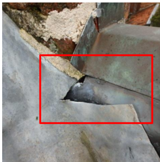
dak [1]-zuid: het lood is te ver ingeknipt, de loodherstelling is ontoereikend
