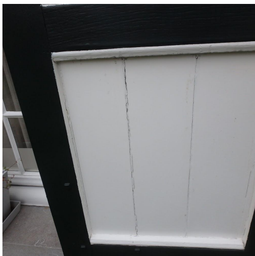
het schilderwerk begint te craqueleren
