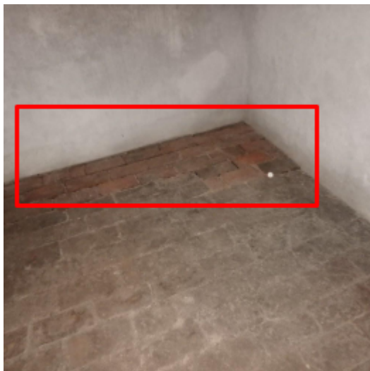
plaatselijk zijn de voegen uitgespoeld
