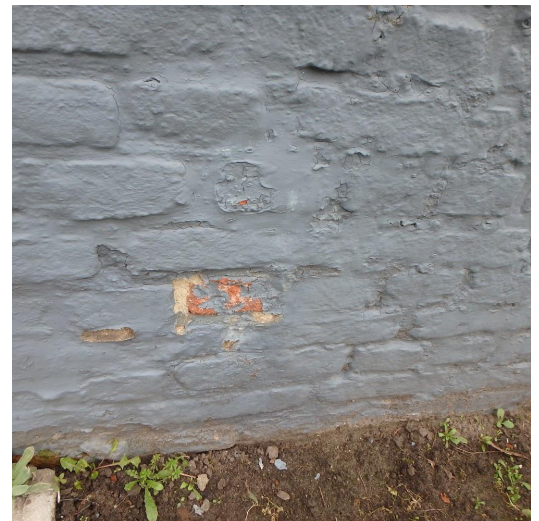
verf bladdert plaatselijk af
