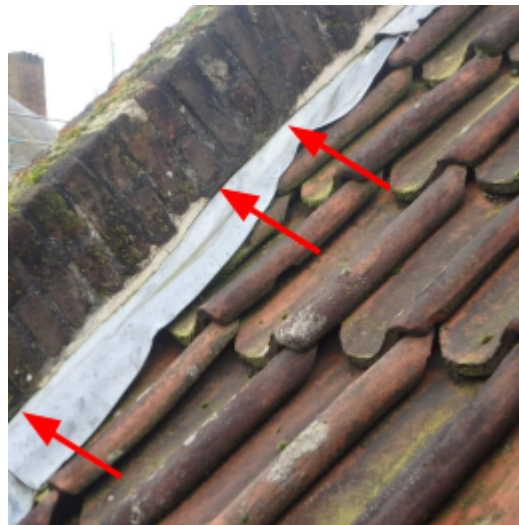
loodslabben niet met krammen bevestigd en voegmortel valt weg
