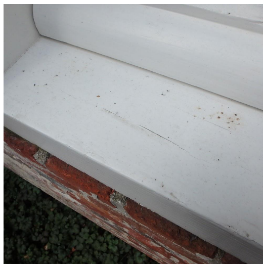
het schilderwerk begint te craqueleren
