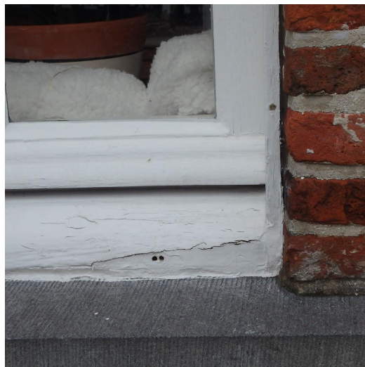
het schilderwerk begint te craqueleren
