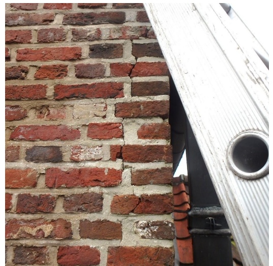
vleugel [1]-noordoostelijke hoek: zettingsscheur mogelijk veroorzaakt door spatkrachten
