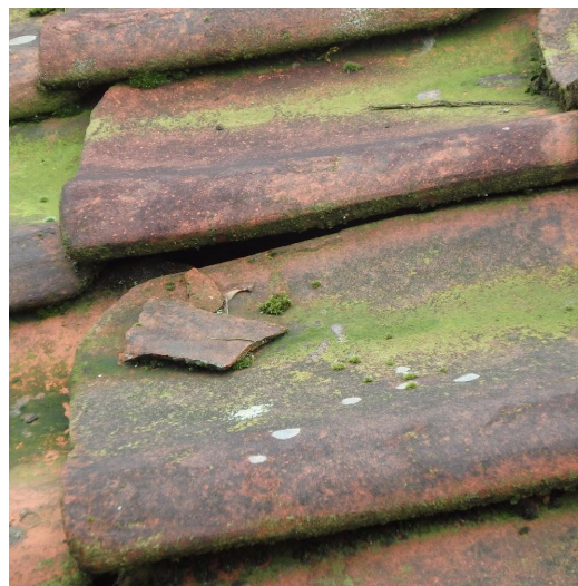
dak [2]: afgeschilferde pan
