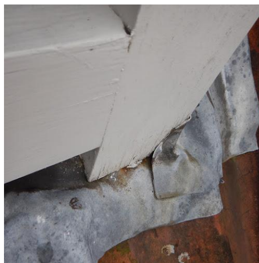
het schilderwerk begint te craqueleren
